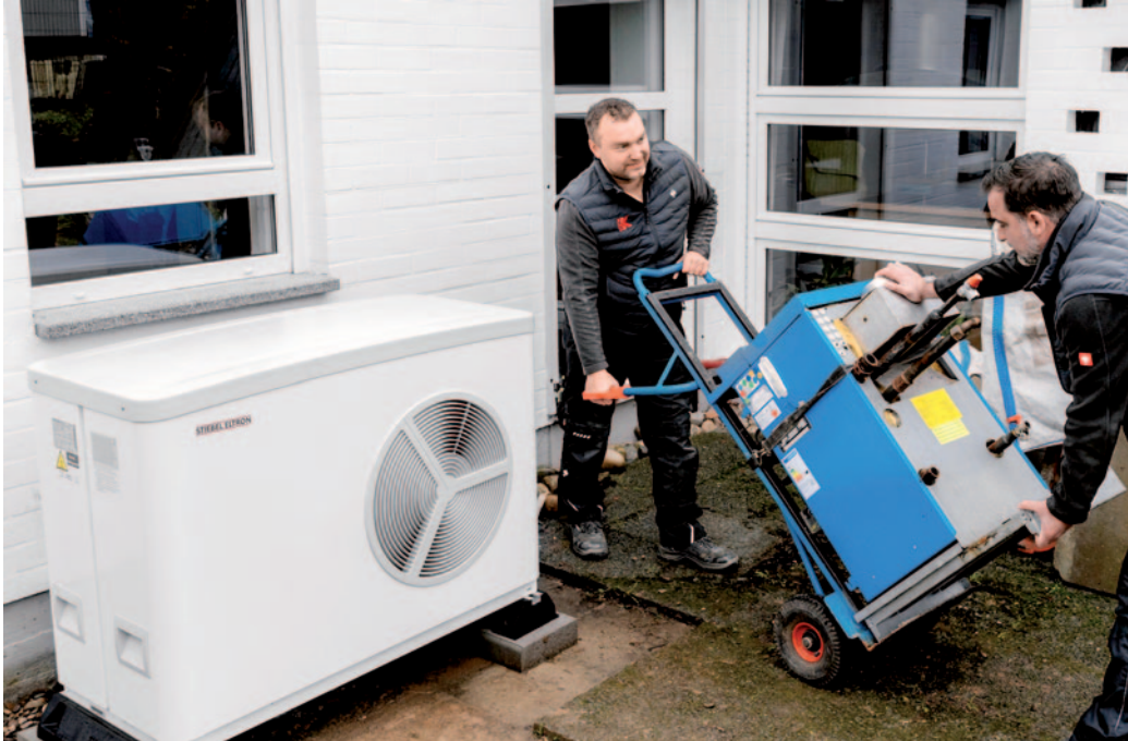
Wer jetzt auf zukunftssichere Wärmepumpenheizung wechselt, profitiert nicht nur von einer Förderung von bis zu 70 Prozent der Kosten – sondern auch von attraktiven Finanzierungsangeboten. Foto: STIEBEL ELTRON
