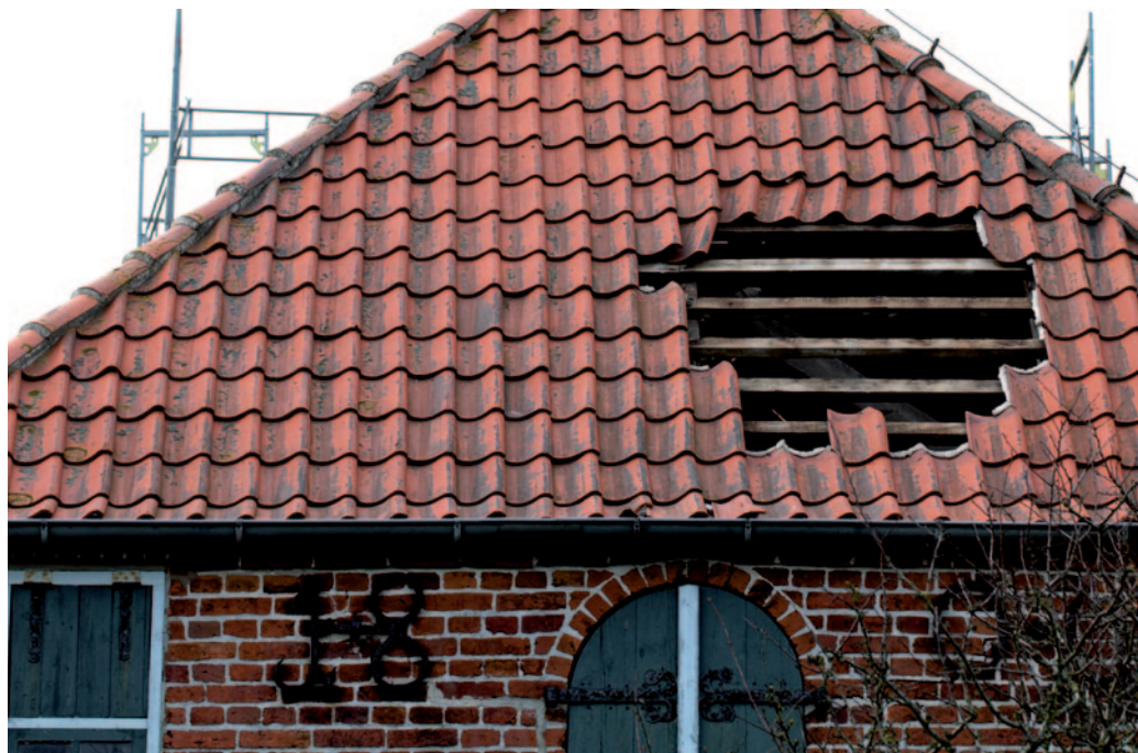
Eine fehlende Windsogsicherung kann bei älteren Dächern häufig zu Sturmschäden führen.
